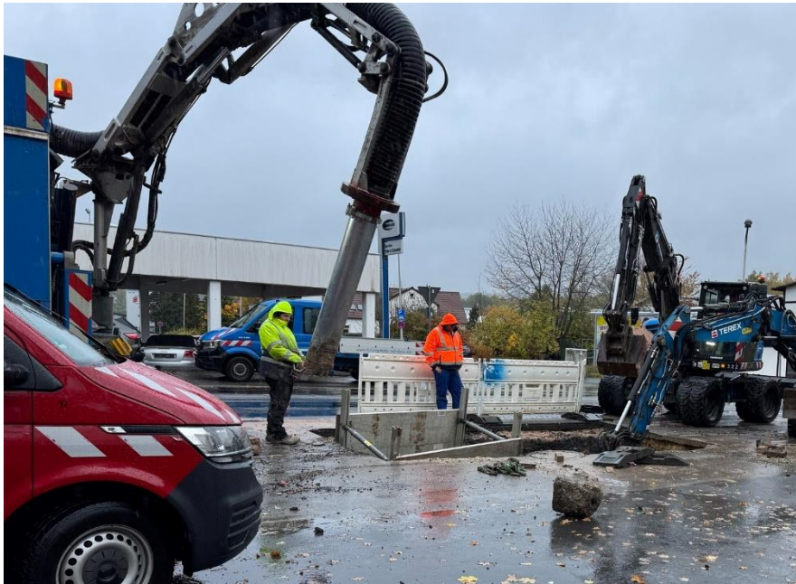
Vermeehrt kommt es zu Rohrbrüchen, wie hier im Oktober 2025 in der Sonneberger Straße.
